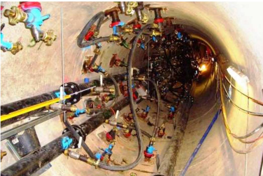
Circuito di distribuzione della salamoia nel cunicolo
